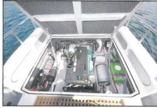
Romslig motorrom og lett tilgjengelige servicepunkter.
